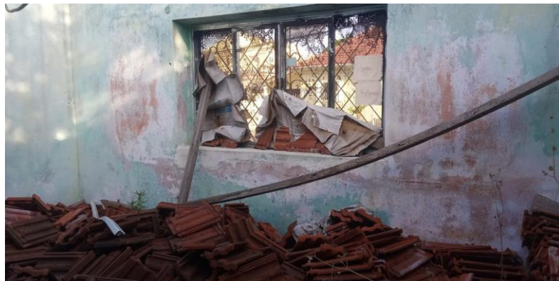
Figura 11- Parede com vários descascamentos e cores. Fonte: Acervo pessoal (2020).
