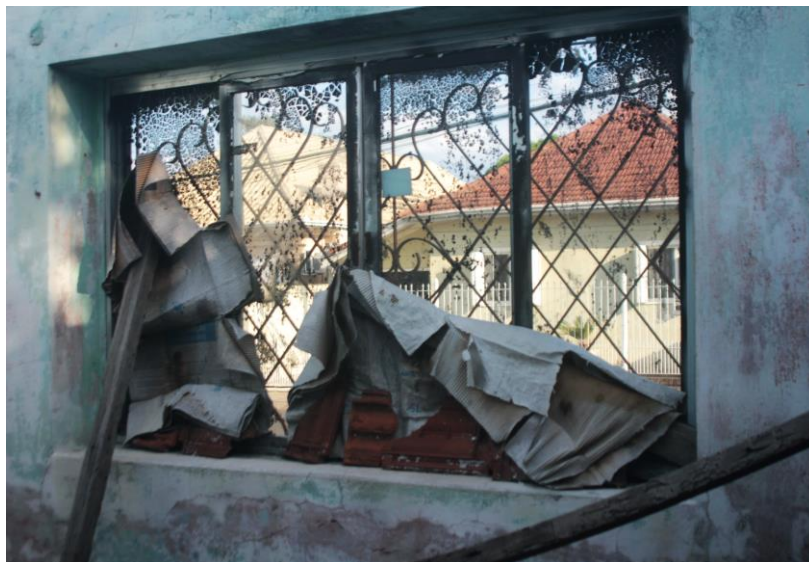
Figura 7 - Janela da fachada com papelões. Fonte: Acervo pessoal (2020).
